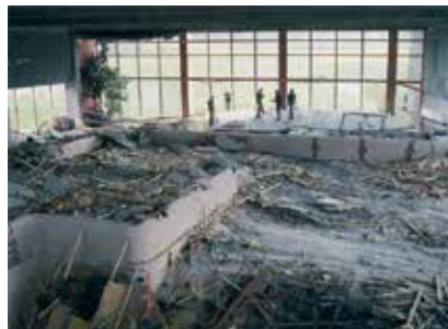
Në 1985, taveni i pezulluar i betonit të një pishine shtëpie në Uster, Zvicër, dështoi. Pezullimi i tavanit i bërë prej çeliku inox nuk tregoi defekt nga jashtë, por nga brenda. Ato u shkatërruan plotësisht nga plasaritja e korrozionit.
